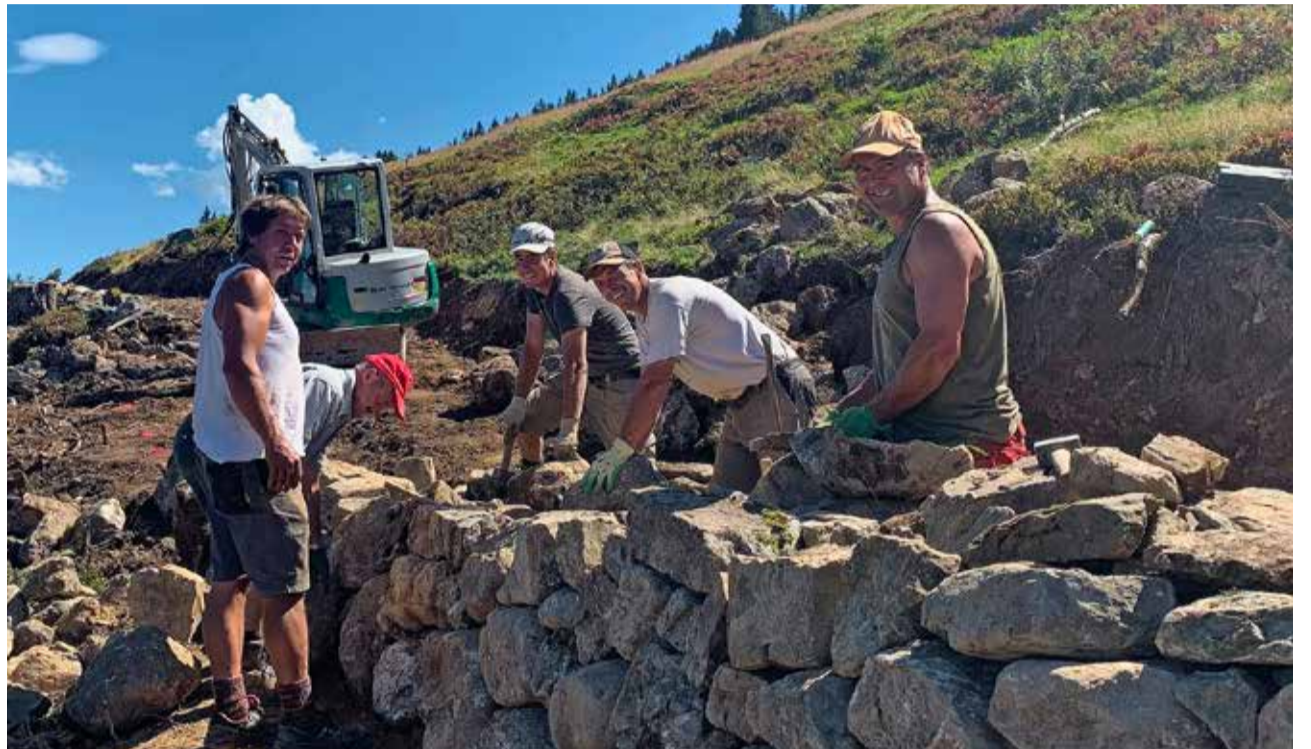
Der Zahn der Zeit: Die Trockenmauer Gafröa/Wildenberg bedarf einer umfassenden Sanierung.
