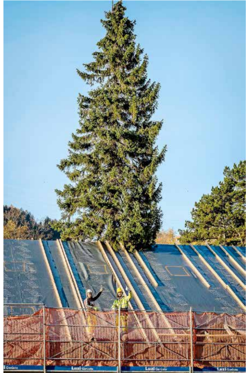
Freudvoller Gruss: Zwei Bauarbeiter winken vom neuen Dach der alten Weberei auf dem Stoffel-Areal in Mels.
